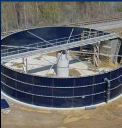
tratamiento de aguas residuales
