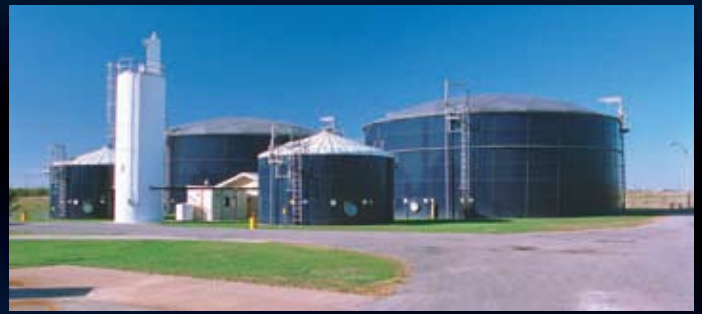
▲ Instalaciones para estabilización y almacenamiento de sedimentos.
